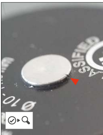
• Remache ligeramente fisurado
