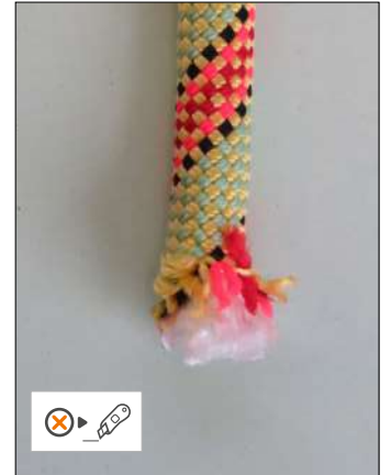
• Puna de cuerda dañada
